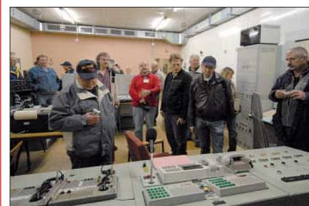
Besichtigung einer Bunker-Schaltzentrale Foto: DL7UMG
